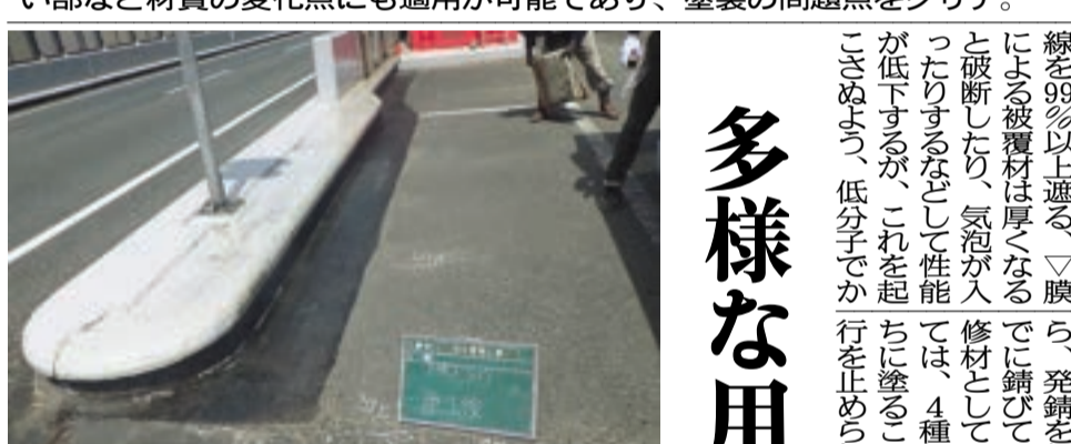
③【高欄・アイランドの取合い部】 アイランド周りの止水対策として、縁石の取合い部分からガッター部まで施工。
